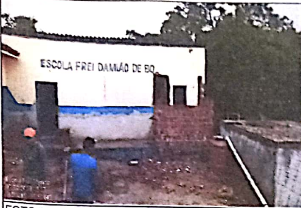
FOTO 01: Avenaria de vedação do PNE.
