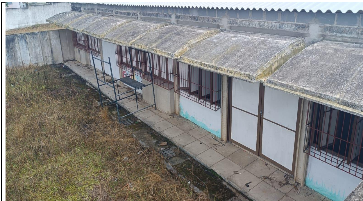
FOTO 05: GRADE DE PROTEÇÃO EM JANELA
