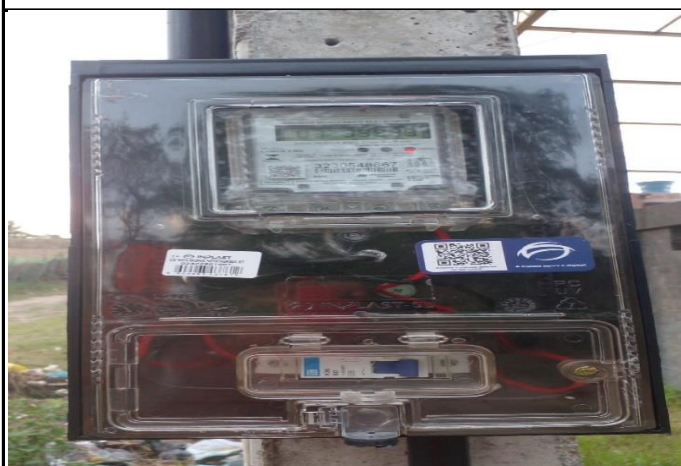
FOTO 03: Entrada de energia provisória.
