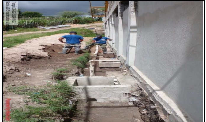
FOTO 04: CAIXA DE PASSAGEM
