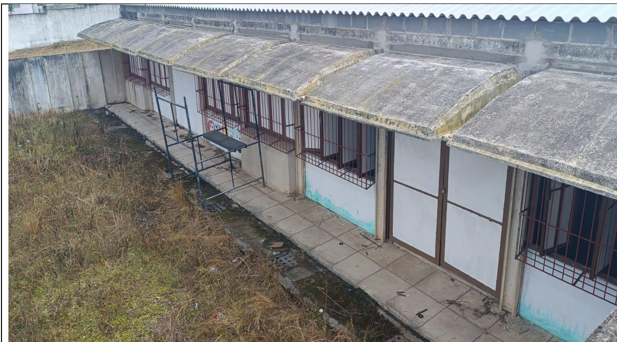
FOTO 05: GRADE DE PROTEÇÃO EM JANELA
