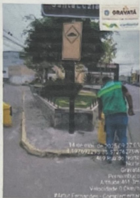
INSTALAÇÃO DE PAPELEIRAS
