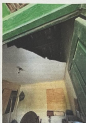
PREDIO ADMINISTRATIVO ATERRO - ANTES DA MANUTENÇÃO E REPAROS (REVISÃO HIDRAÚLICA, ELÉTRICA, COBERTA E PINTURA)
