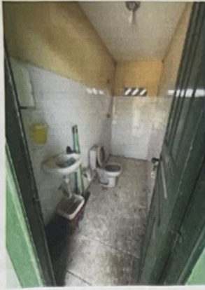
PRÉDIO AMINISTRATIVO ATERRO - ANTES DA MANUTENÇÃO E REPAROS (REVISÃO HIDRAÚLICA, ELÉTRICA, COBERTA E
