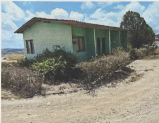
PRÉDIO AMINISTRATIVO ATERRO - ANTES DA MANUTENÇÃO E REPAROS (REVISÃO HIDRAÚLICA, ELÉTRICA, COBERTA E
